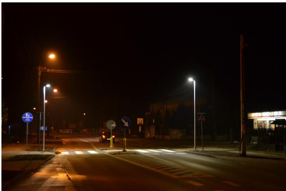
Doświetlenie przejścia dla pieszych przy posesji nr 539 w Wojcieszynie
